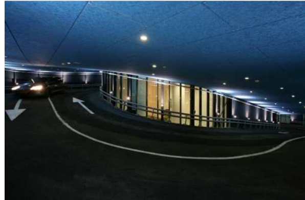
Het Tectum plafond in de hellingbaan
